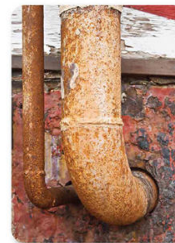
Fig. 4.40 La corrosión de una tubería corresponde a un fenómeno de oxidación.
