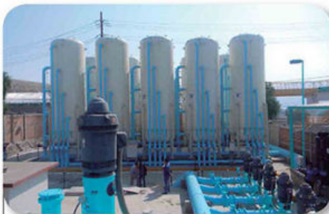
Fig. 4.29 Planta potabilizadora en el Distrito Federal.
